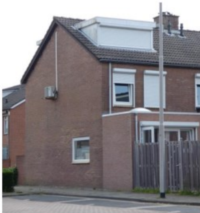
Niet passend plaatsing aan plaatsing aan de zijgevel en leidingen in het zicht
