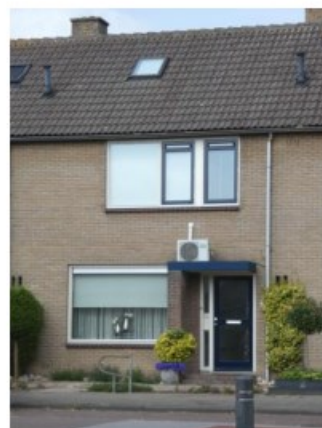
Niet passende airco-unit aan de voorgevel
