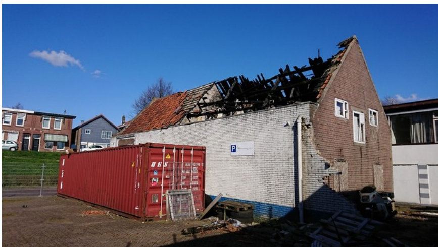
Afbeelding 4: De Ooststraat 80, het verbrande gebouw.
