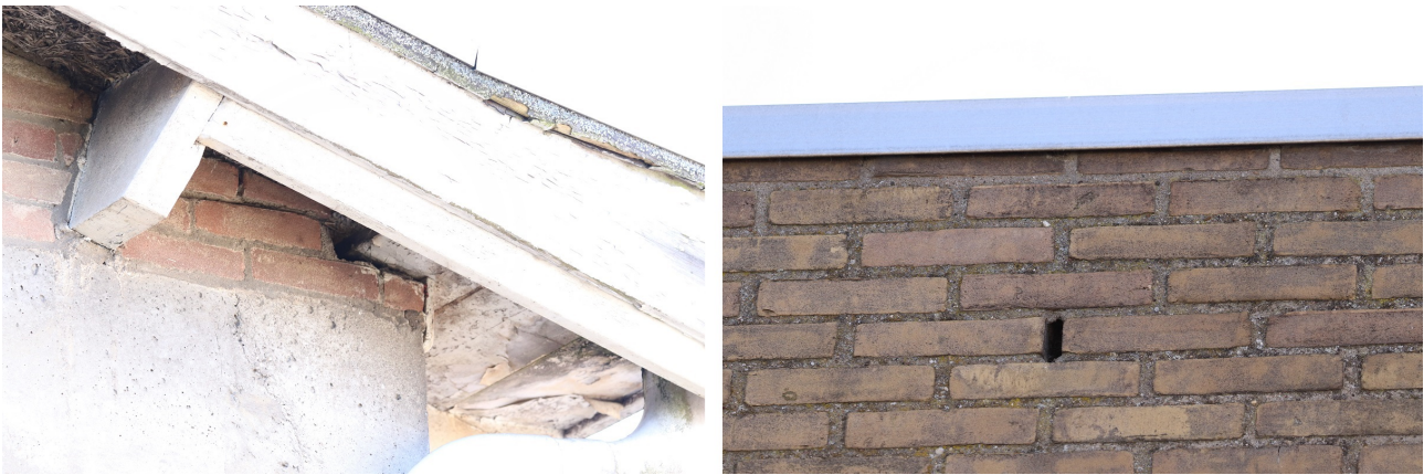
Afbeelding 8: Openingen tussen gevel en dakvlak of open stootvoegen zijn potentiële vleermuisverblijfplaatsen.
