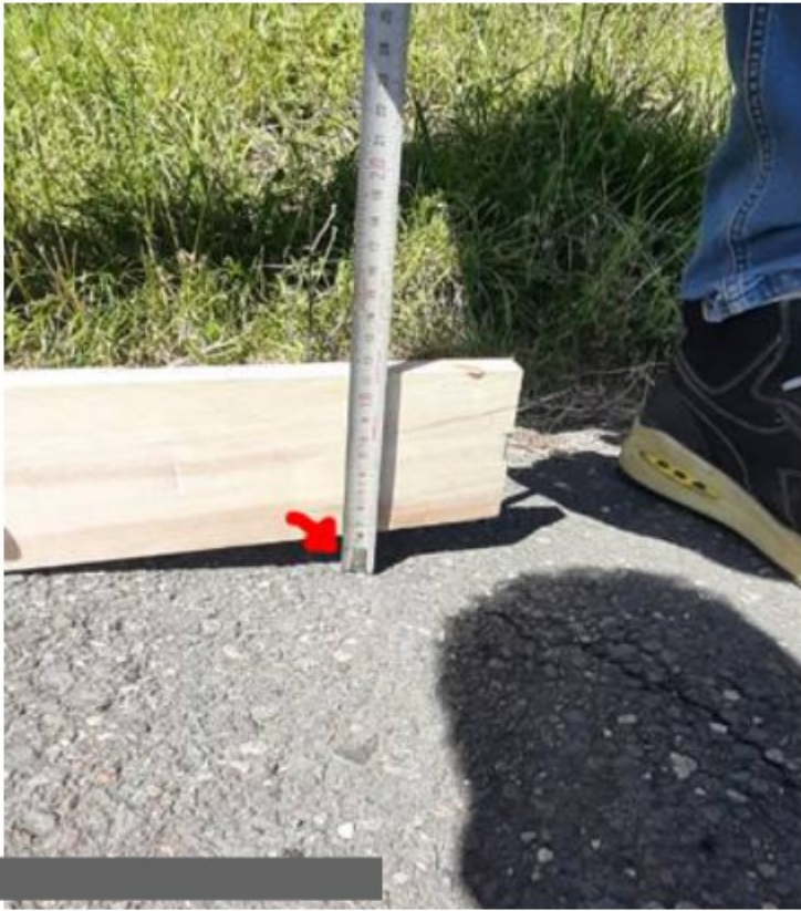
Boomwortel onder asfalt doorsnede( ca. 5 cm)
