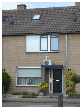
Niet passende airco-unit aan de voorgevel
