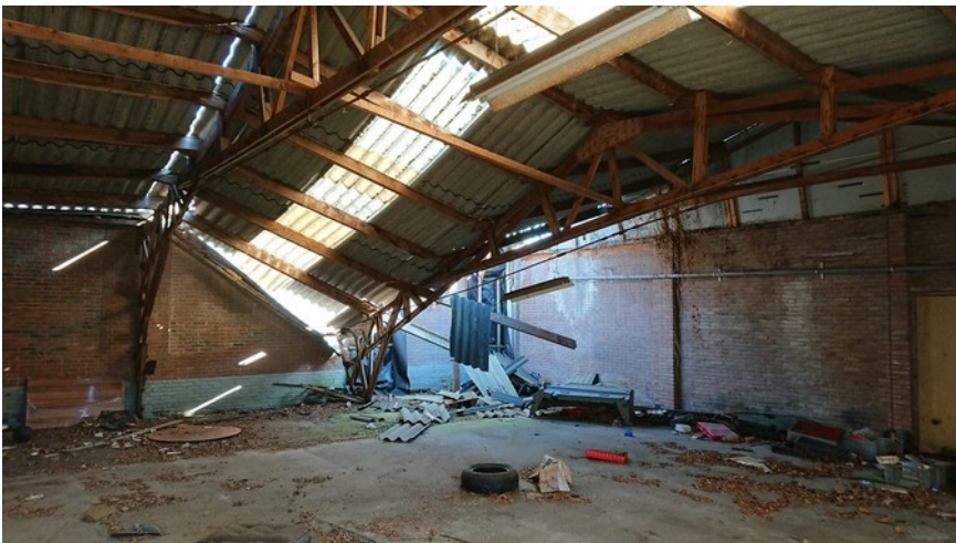
De kleine loods aan de achterzijde met het ingestorte dak
