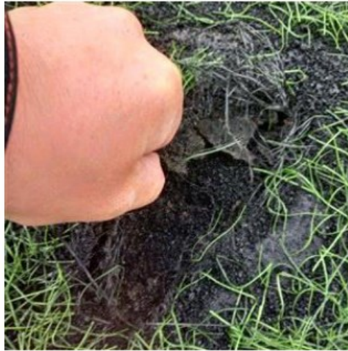
Gat in de toplaag
