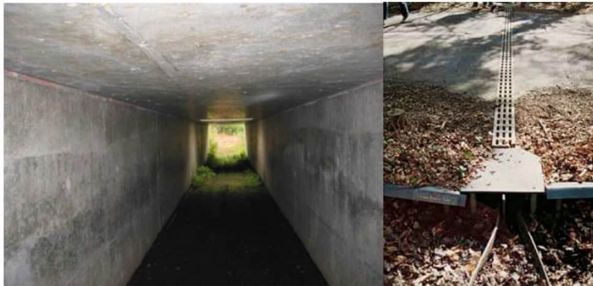
Figuur 22.4 Voorbeelden van faunatunnels met extra lichtinval (bron: Leidraad Faunavoorzieningen bij Infrastructuur)
